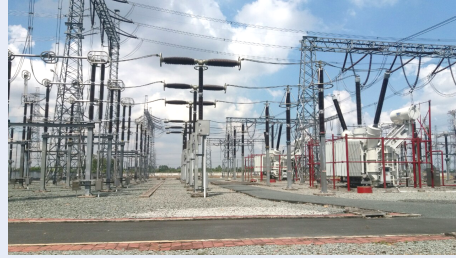
Hình 5: Ngăn lộ kháng bù ngang 500 kV – 128 Mvar tại TBA 500 kV Ô Môn.
