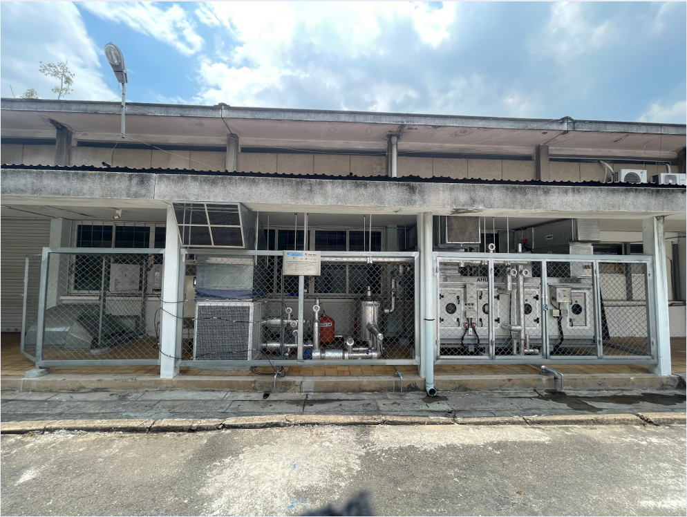
Hình 1: Tổng quan hệ thống Chiller dùng làm thí nghiệm
