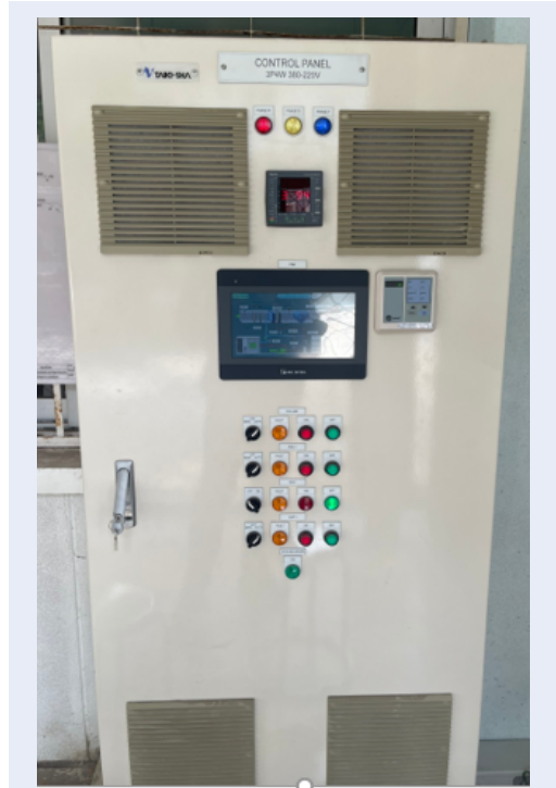
Hình 3: Tủ điều khiển hệ thống Chiller với màn hình giao diện cảm ứng
