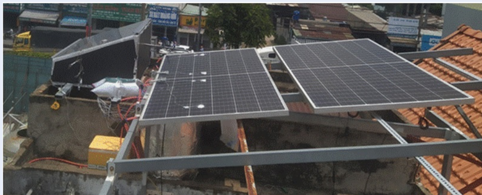
Hình 3: Tổng thể bố trí các thiết bị của hệ thống PV/T thực nghiệm
